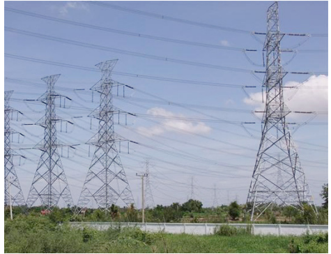
เสาไฟฟ้า
